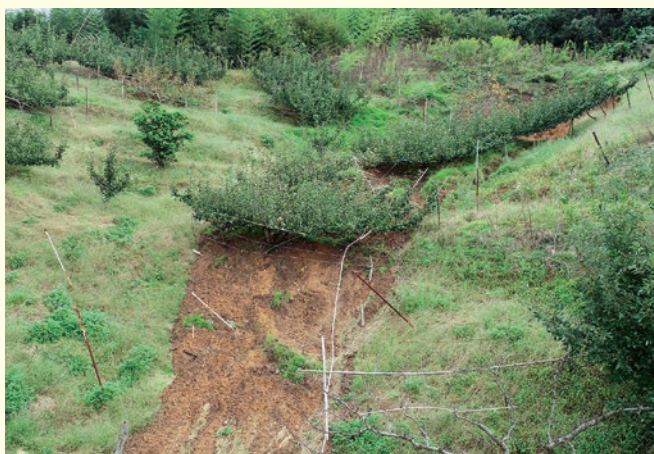
湯梨浜町 梨 土砂崩れ
