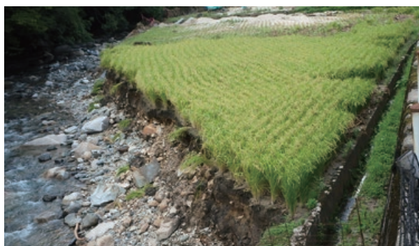
令和5年の台風7号による水田崩壊
